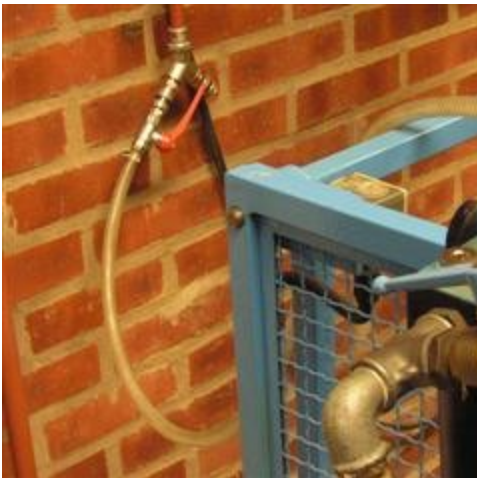
Bild 1: Tryckluftkranen bakom maskinen.
